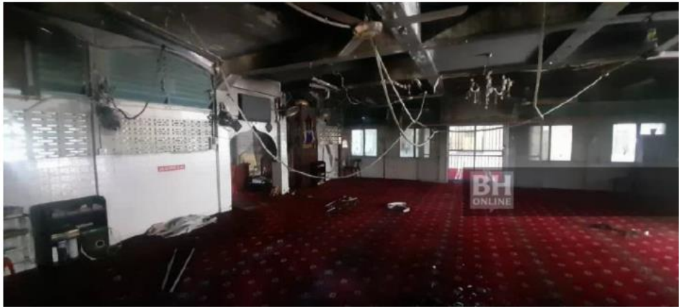
Ruang solat Keadaan Masjid Jamek Kampung Bongek Rembau yang musnah dalam kebakaran pagi tadi - Foto NSTP/Bomba
